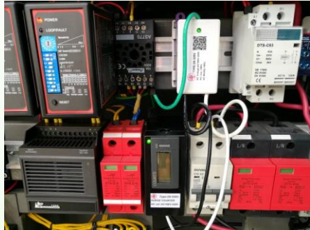
ติดตั้งที่ตู้ควบคุมสัญญาณไฟจราจรพร้อมกับติดตั้งตัวนับการเกิดไฟกระชาก
