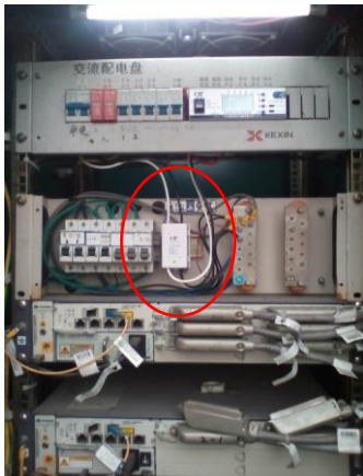
ติดตั้งที่สถานีโทรคมนาคมกลางแจ้ง
